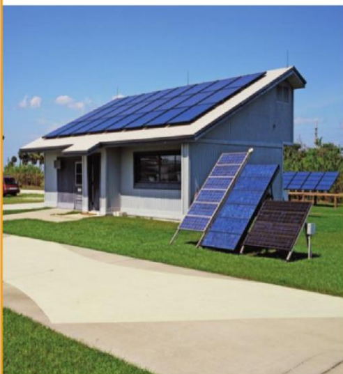
Paneles de energía solar.
